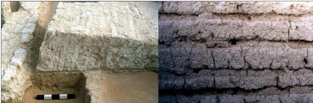
Figuur 55: Omgevallen leemtegelmuur te Rumeilah
